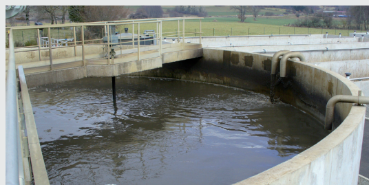
Station d'épuration à boues activées, Noirétable
