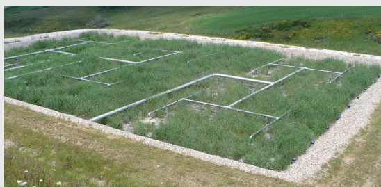
Filtre planté de roseaux, Le Bessat
